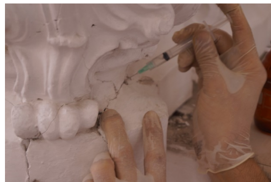
FIG. 14: Tratamiento preventivo en las fisuras y grietas, utilizando el adhesivo Movithal B60H al
